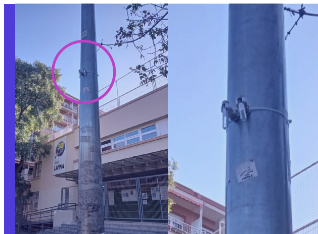
Figura 6. Tubos de difusión de NO 2 instalados en farolas.
